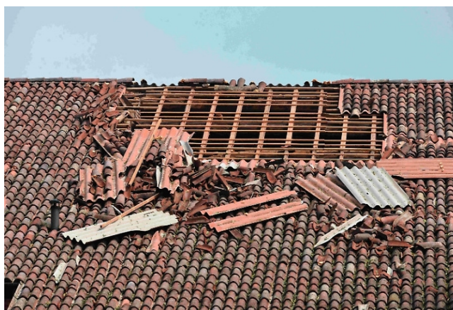
Foto 4 – Tetto di un'azienda di Pozzo Baronzio in provincia di Cremona distrutto dalla grandine
